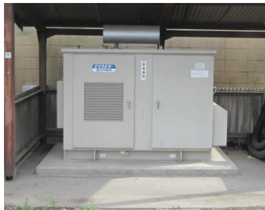
非常用発電機
